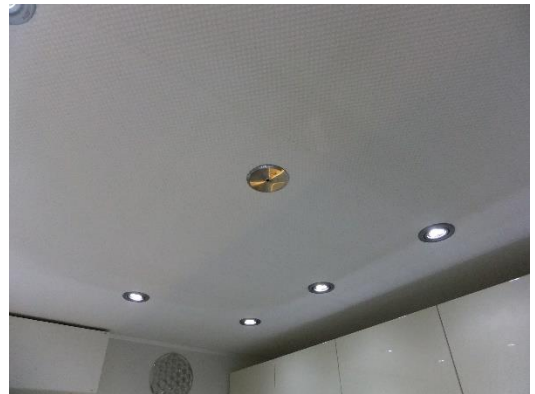
Duftauslaß in einer Küchendecke
